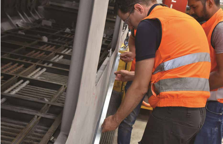
▲ Bild 9. Verzugssituation mit dem Richtscheit vermessen und mit Kreide die Beultiefen an verschiedenen Stellen anzeichnen
